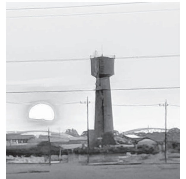
浄水場設備は今すぐ更新が必要だが、水道料金の値上げも伴う。
