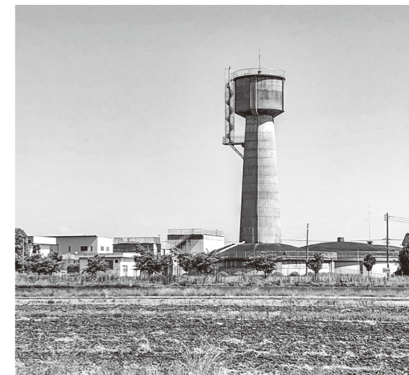
老朽化が進む浄水場施設
