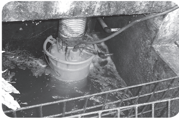
設置した揚水ポンプ
