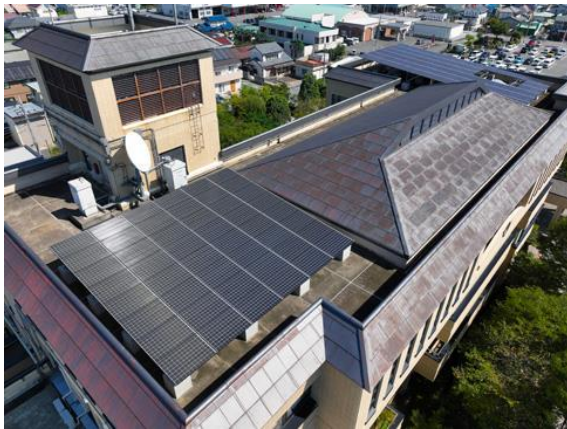
太陽光発電システム（庁舎屋上）
