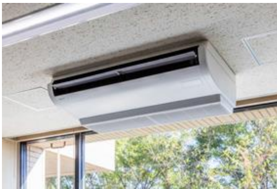
庁舎内空調設備
