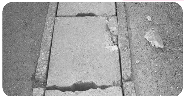
補修が必要な道路
