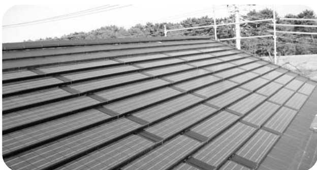
屋根と一体型のソーラーシステム
